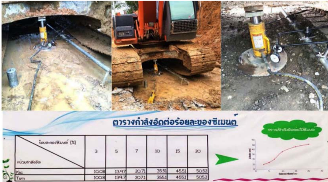
รูปที่ 3-9 การทดสอบความแน่นของฐานรากอาคารหลังการทำชอยซีเมนต์ และกำลังอัดต่อร้อยละของซีเมนต์
