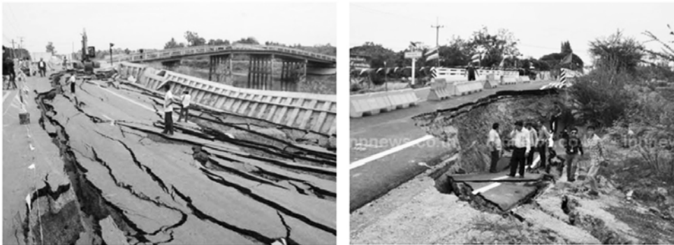
รูปที่ 1 การวิบัติ (ทรุดตัว พังทลาย) ของถนนบนคันคลองชลประทานในเขตที่ราบลุ่มแม่น้ำเจ้าพระยาตอนล่าง
