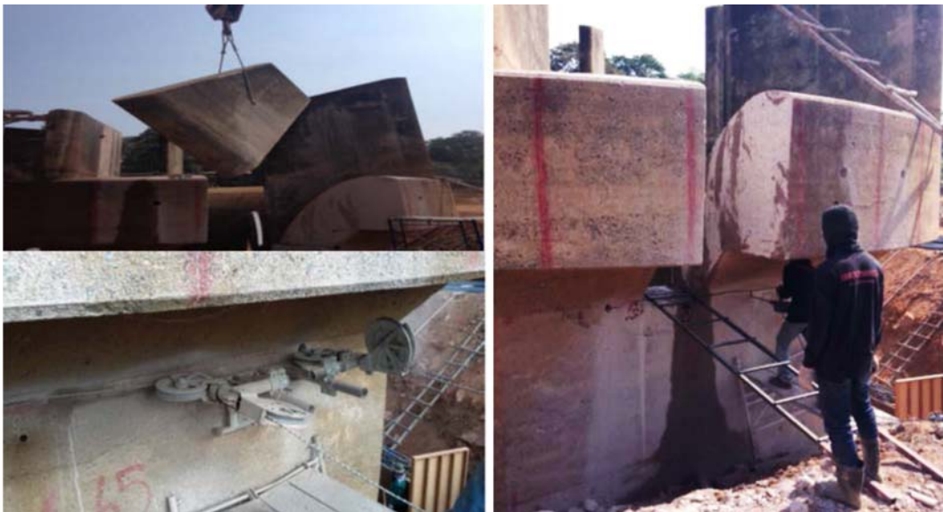
รูปที่ 3-49 งานตัดคอนกรีตและเคลื่อนย้ายแท่งคอนกรีต
