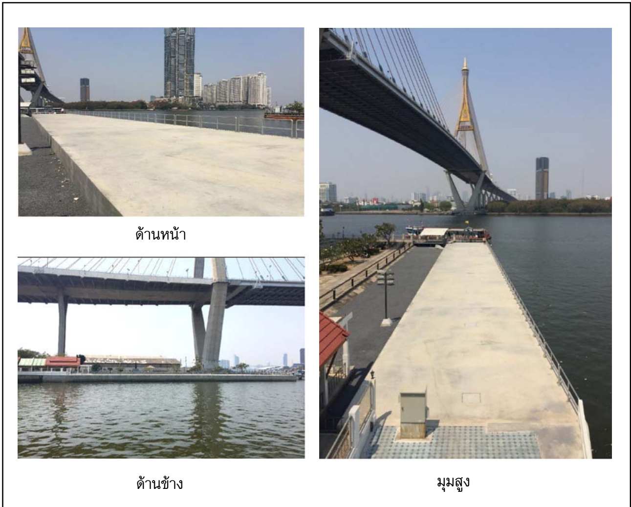
รูปที่ 3-8 ภาพถ่ายเขื่อนป้องกันตลิ่งฝั่งขวา (หลังดำเนินการแล้วเสร็จ)
