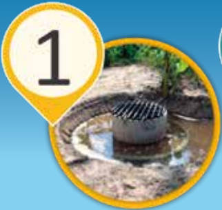
ระบบเติมน้ำใต้ดินระดับต้นผ่านบ่อวงคอนกรีต
