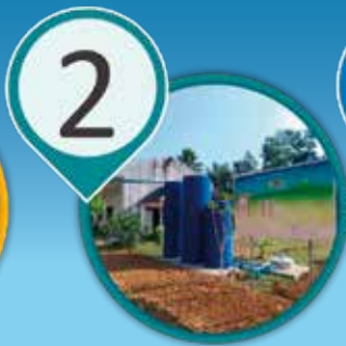
ระบบเติมน้ำฝนจากหลังคาผ่านบ่อวงคอนกรีต
