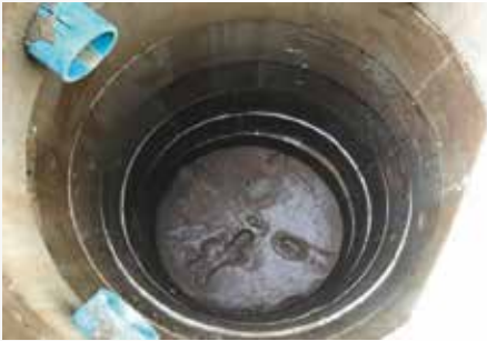
(1) ตะกอนอุดตันภายในบ่อเติมน้ำ
