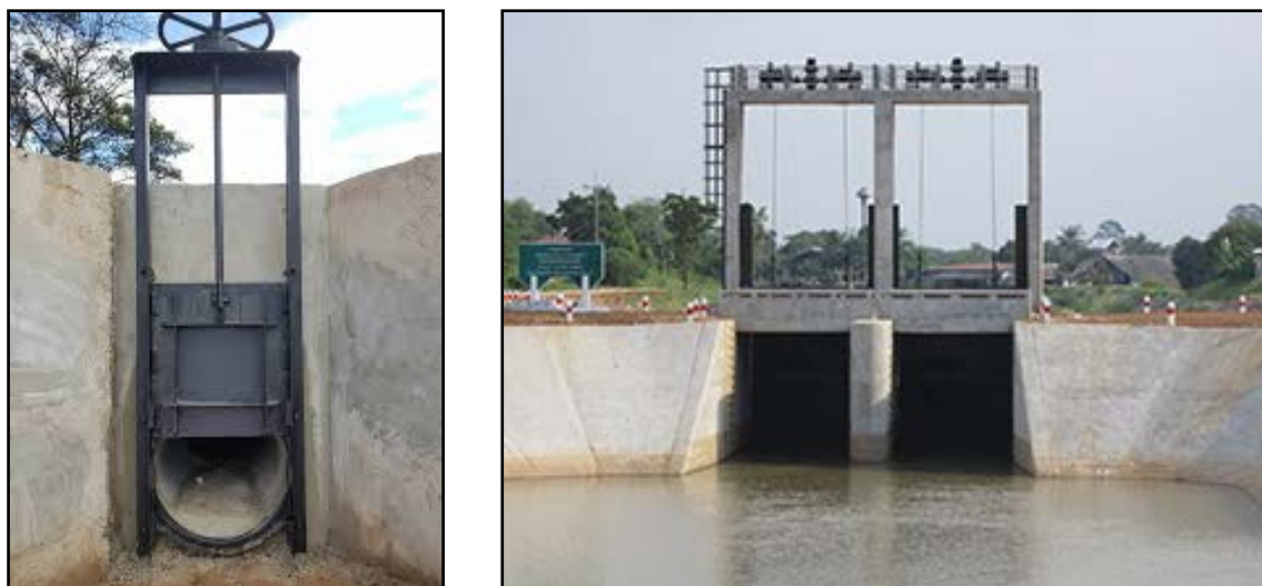
รูปที่ 6.26 ประตูควบคุมน้ำชนิดบานตรง
