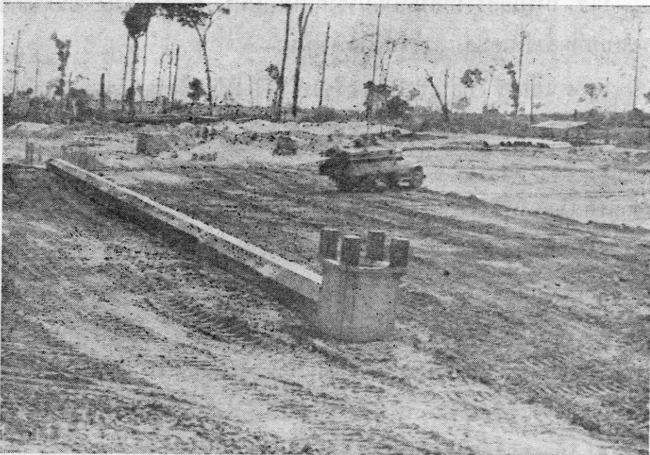
รูปที่ 10.3 งานก่อสร้างท่อระบายน้ำจากอ่างเก็บน้ำ
