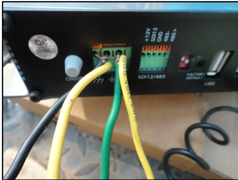
ภาพที่ 22 ต่อไฟตรงจากแหล่งจ่ายไฟตรง (Power Supply) ยี่ห้อ INTAW รุ่น S-50-12 เพื่อจ่ายไฟให้แก่เครื่อง RTU และเครื่องวัดระดับน้ำแบบแรงดันยี่ห้อ SIEMENS รุ่น MPS series
