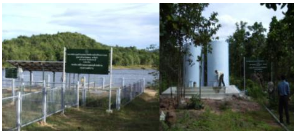
ภาพที่ 7 ระบบสูบน้ำพลังงานแสงอาทิตย์และถังเก็บน้ำ
