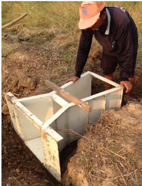
ภาพที่ 3.5 การติดตั้งรางวัดน้ำแบบไม่มีคอ (Cut-throat Flume)
