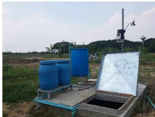
ภาพที่ 21 ถังบอกรปริมาณการใช้น้ำ แบบระบายน้ำ
