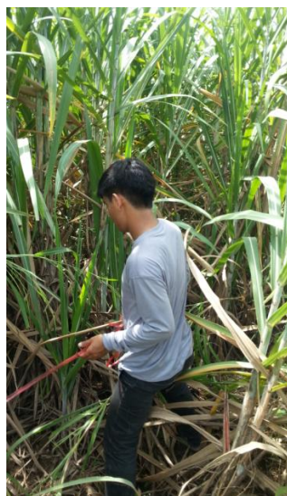
ภาพที่ 10 การปักหมุดระบุตำแหน่งที่จะฝังท่อ
