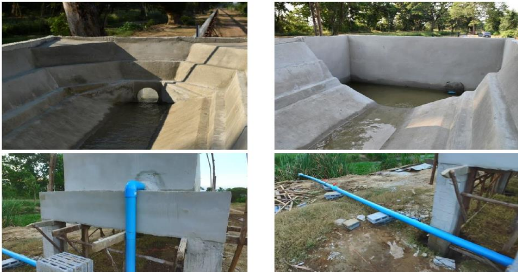
รูปที่ 3(e) อาคารรับน้ำออกด้านท้ายน้ำมีความยาว 4.82 เมตร จากรายงานสรุปผลการจัดทำแบบจำลองกายภาพอุโมงค์ผันน้ำ, โดยสถาบันเทคโนโลยีแห่งเอเชีย (Asian Institute of Technology).
