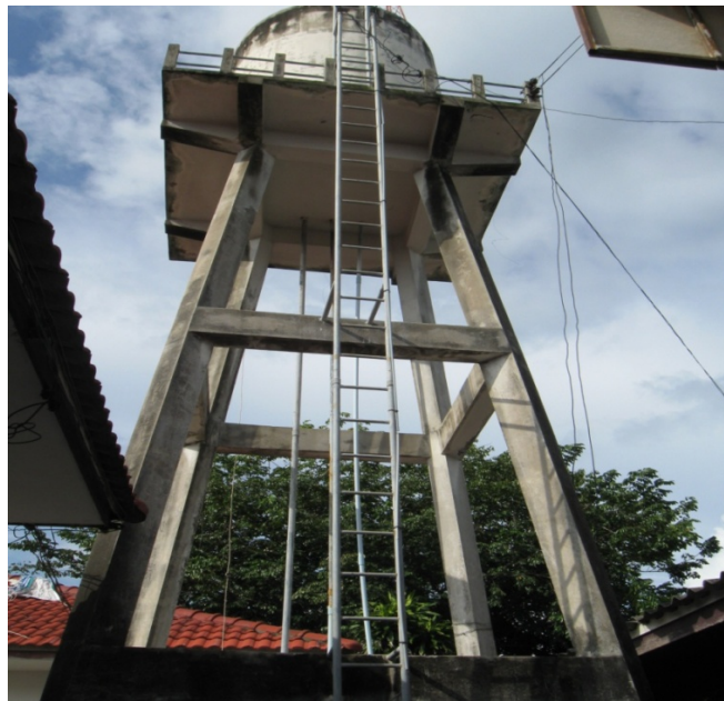
รูปภาพผนวกที่ 10 หอดังสูงหมู่ที่ 8 บริเวณ บ้านนาขอบ ปีนแก้ว
