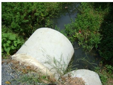
ท่อรับน้ำเสียดัง หัวมุดฝั่งขวาติดกับถนนใหญ่
