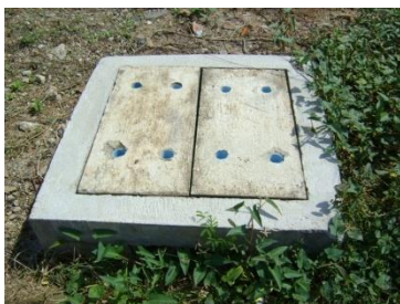
ท่อรับน้ำเสีย หัวมุมด้านขวามือซอยเทศบาล 11
