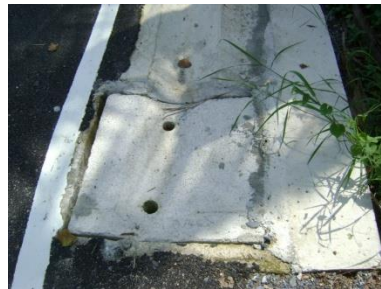
ท่อรับน้ำเสียดัง หัวมุดฝั่งซ้ายติดกับถนนใหญ่
