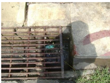
ท่อรับน้ำเสีย อยู่ใกล้สำนักงานบรรเทาสาธารณภัย
