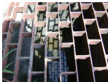
ท่อรับน้ำเสีย หัวมุมตรงข้ามเซเว่น
