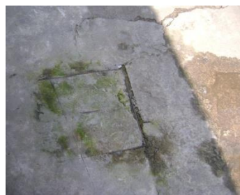
ท่อรับน้ำเสีย อยู่ตรงกลางซอยกลางตลาดฝั่งซ้าย
