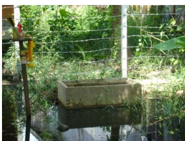
ท่อรับน้ำเสีย อยู่แถวบริเวณแทงน้ำที่ 3
