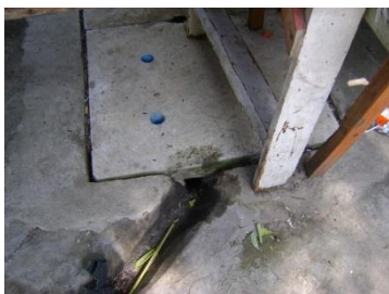
ท่อน้ำเสีย หัวมุมถนนฝั่งซ้ายหน้าวัด
