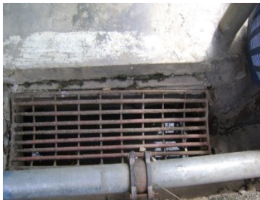
ท่อรับน้ำเสีย หัวมุมฝั่งซ้ายซอยเทศบาล 5
