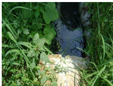
ท่อรับน้ำเสียดัง ตรงหน้าป้ายวัดบางหลวง
