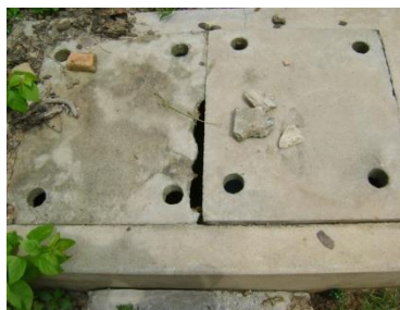
ท่อรับน้ำเสีย อยู่ตรงกลางซอยเทศบาล 3
