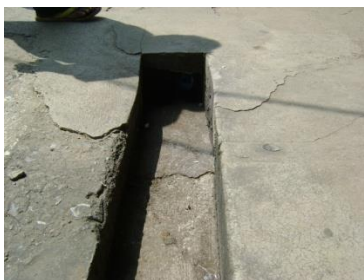
ท่อรับน้ำเสีย หัวมูมถนนกลางตลาดบางหลวงฝั่งขวา
