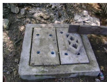
ท่อรับน้ำเสีย ตรงสี่แยกซอยเทศบาล 11 อยู่ ซ้ายมือลึกเข้าไปประมาณ 1 เมตร
