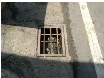
ท่อรับน้ำเสีย อยู่ข้างเซเว่น
