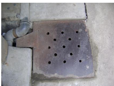
ท่อรับน้ำเสีย อยู่ตรงข้ามหัวมูมถนนกลางตลาด บางหลวงฝั่งขวา
