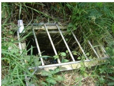
ท่อรับน้ำเสีย อยู่หน้าโรงเรียนเจ็ยน์หัว
