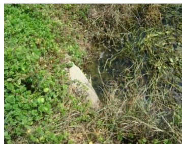
ท่อรับน้ำเสีย มุมถนนซ้ายมือถนนเทศบาลซอย 11
