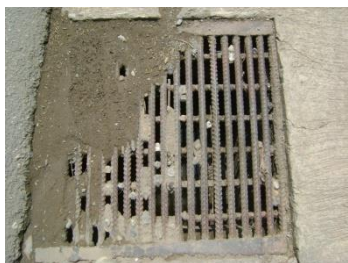
ท่อรับน้ำเสีย หัวมุมถนนทางหลวงแผ่นดิน ทางไปตลาดบางหลวง
