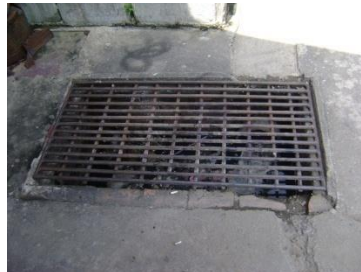
ท่อรับน้ำเสีย หลังร้านขายของบริเวณศาลาประชาคม
