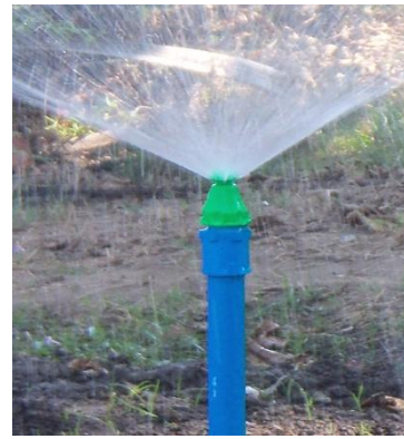
รูปที่ 6 หัวจ่ายน้ำ “ชลประทาน 1”
