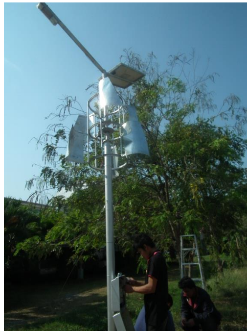
ภาพที่ 3.8 โคมไฟที่ติดตั้งอุปกรณ์เสร็จเรียบร้อยแล้ว
