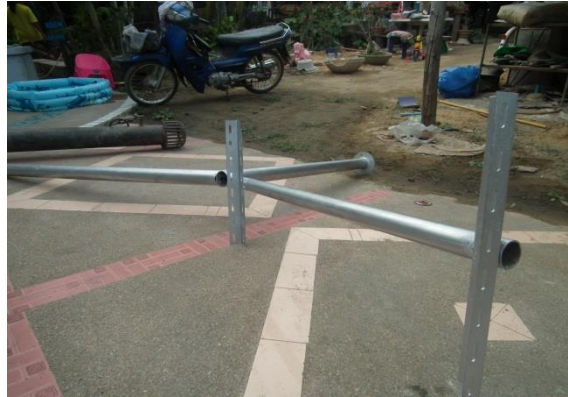
ภาพที่ 3.7 เสาช่วงที่ติดตั้งโคมไฟ และแผงโซลาร์เซลล์
