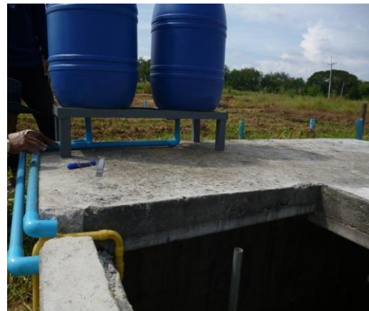
ภาพที่ 24 การต่อท่อ PVC 1 นิ้วจากถังจ่ายน้ำ
