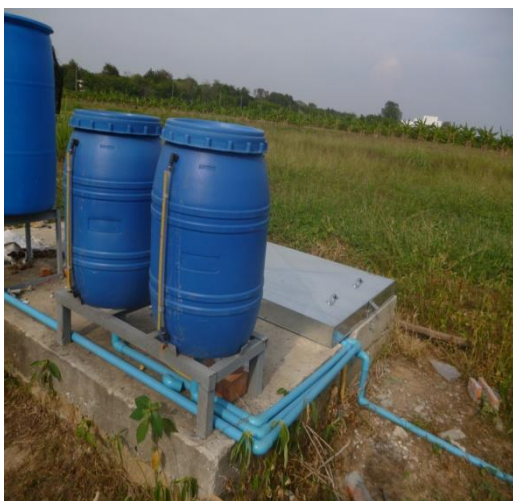
ภาพที่ 34 ถังจ่ายน้ำเมื่อทำการติดตั้งเสร็จแล้ว
