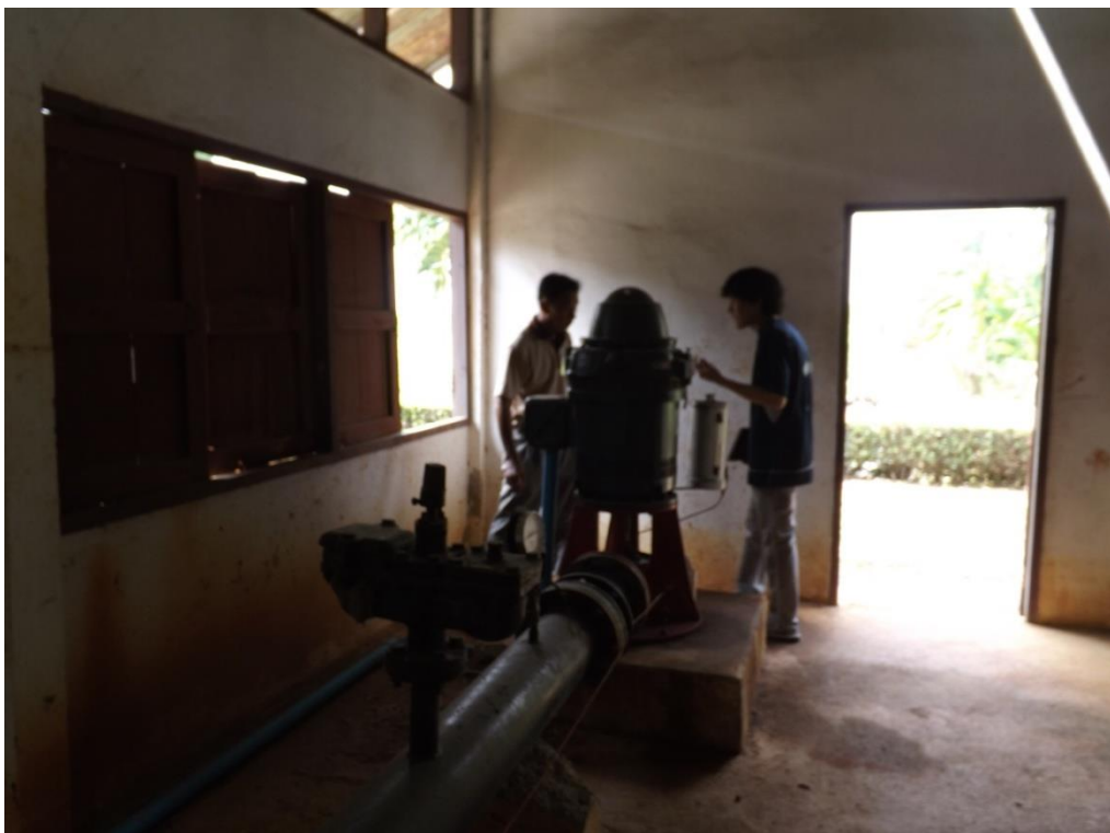
ภาพที่ 3.3.3 เดินเครื่องปั้มน้ำในบ่อสูบทดสอบ
