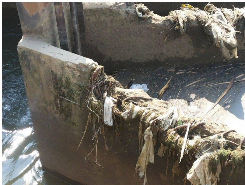
ภาพที่ 4-11 ความเสียหายที่เกิดจากการกระทำของมนุษย์ของท่อลอดถนน (อาคารอัดน้ำ) คลอง 2R-5L-2L กม. 7+291
