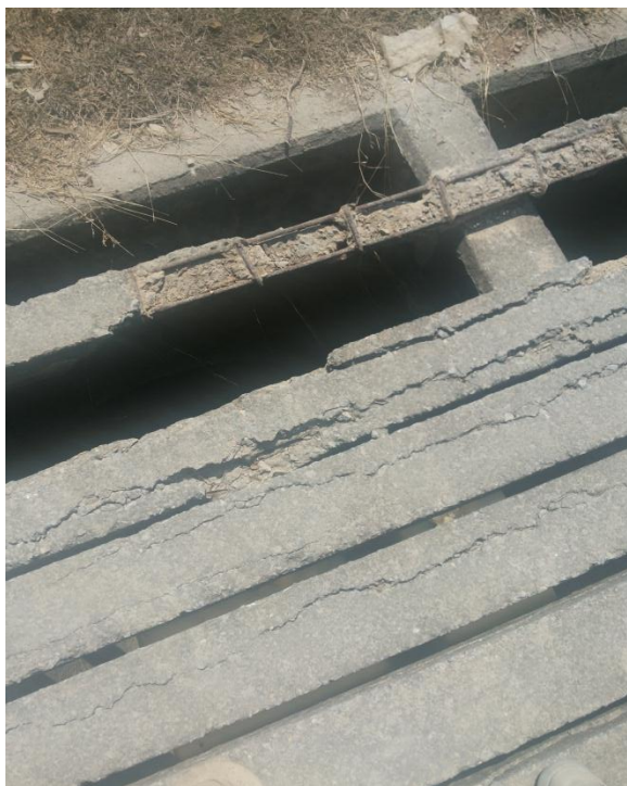
ภาพที่ 4-1 การเกิดรอยร้าวขนานกับผิวเหล็กเสริมในคอนกรีต (Delamination) ของท่อลอดถนน (อาคารอัดน้ำ) คลอง 4R-5L-2L กม. 3+650
