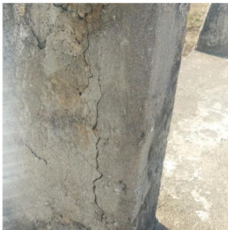
ภาพที่ 4-2 การเกิดรอยร้าวขนานกับผิวเหล็กเสริมในคอนกรีต (Delamination) ของท่อนลอดถนน (อาคารอัดน้ำ) คลอง 4R-5L-2L กม. 3+650
