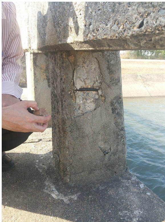
ภาพที่ 4-5 การเกิดเหล็กเสริมยื่นออกมาจากโครงสร้างสะพานรถยนต์คลอง 2L กม. 21+216
