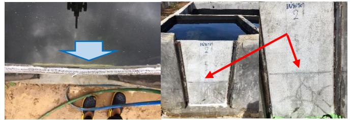
ภาพที่ 28 การโค้งตัวของผ้าใบคอนกรีตขณะใส่น้ำเพื่อทดลอง และรอยแตกที่เกิดจากแรงดันน้ำ
