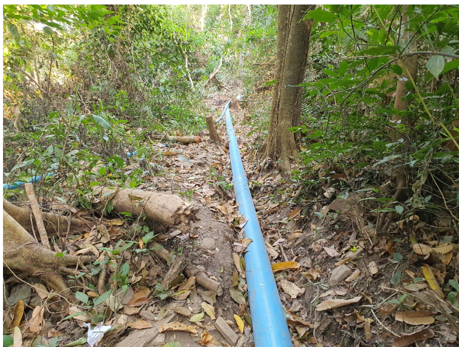
รูปผนวกที่ 11 แสดงการติดตั้งท่อลำเลียงน้ำไปยังเครื่องกำเนิดไฟฟ้า
