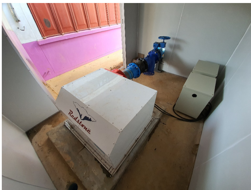
รูปผนวกที่ 19 แสดงการติดตั้งเครื่องกำเนิดไฟฟ้า
