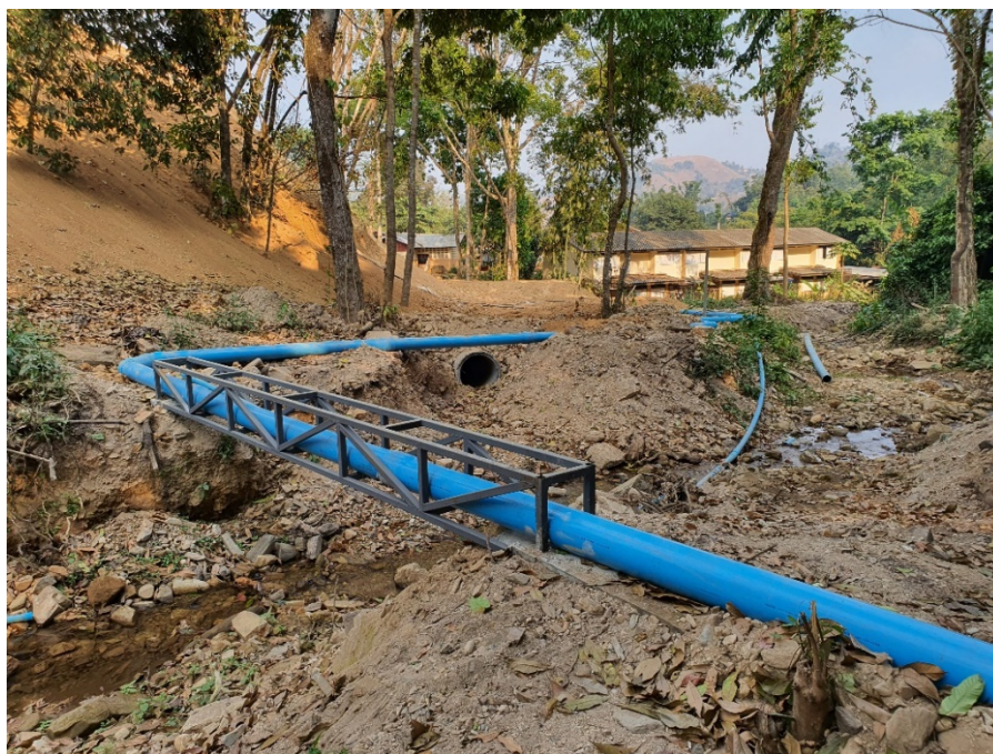
รูปผนวกที่ 12 แสดงการติดตั้งท่อลำเลียงข้ามผ่านลำน้ำเดิม
