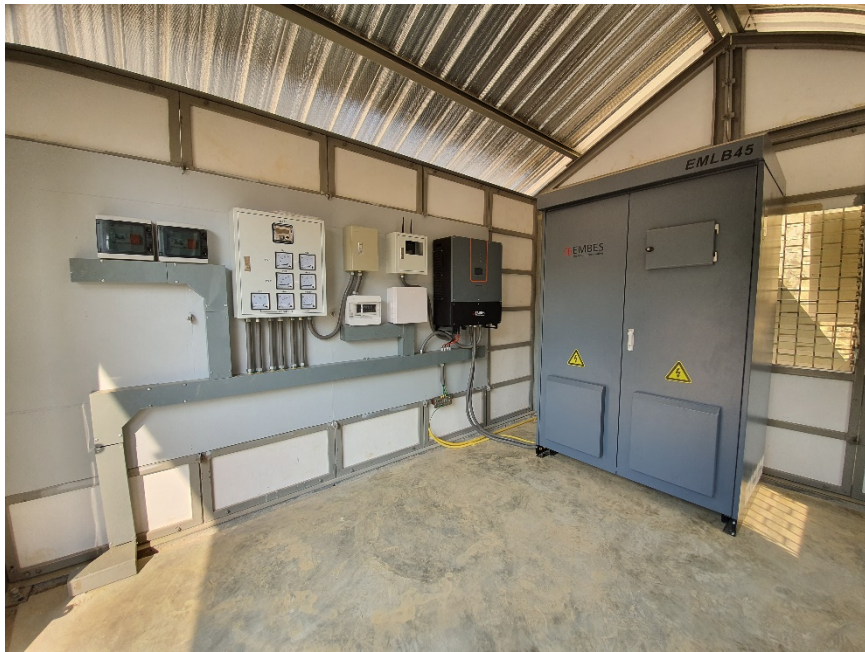
รูปผนวกที่ 20 แสดงการติดตั้งตู้ไฟฟ้า
