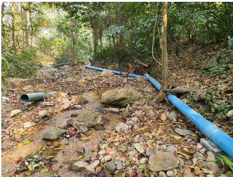
รูปผนวกที่ 10 แสดงการติดตั้งท่อลำเลียงน้ำไปยังเครื่องกำเนิดไฟฟ้า
