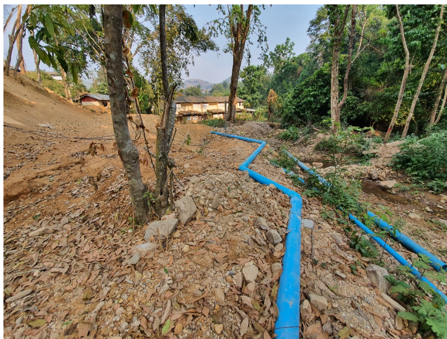
รูปผนวกที่ 13 แสดงการติดตั้งท่อลำเลียงน้ำไปยังเครื่องกำเนิดไฟฟ้า
