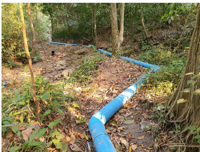
รูปผนวกที่ 9 แสดงการติดตั้งท่อลำเลียงน้ำไปยังเครื่องกำเนิดไฟฟ้า
