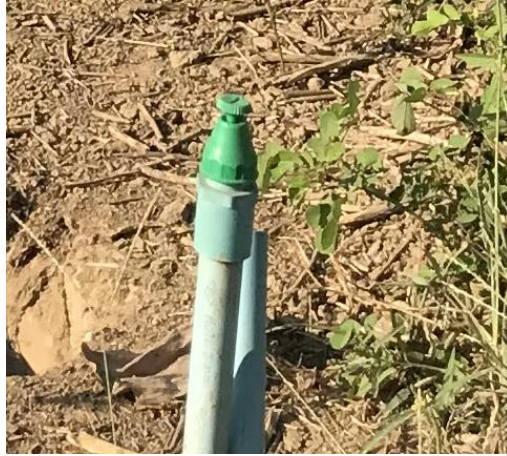
รูปที่ 3.3 หัวจ่ายน้ำชลประทาน 1
