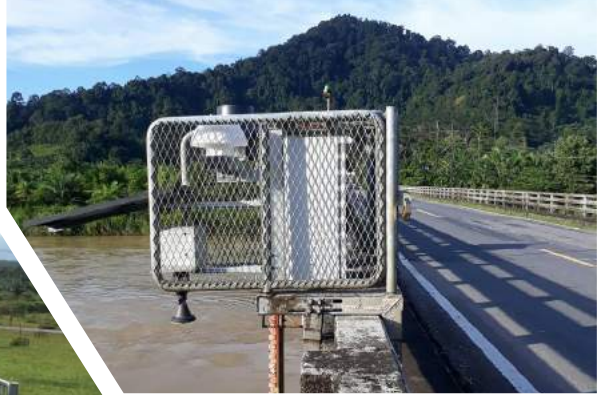
สถานีโทรมาตรตรวจวัดระดับน้ำอัตโนมัติ Automatic water level station
