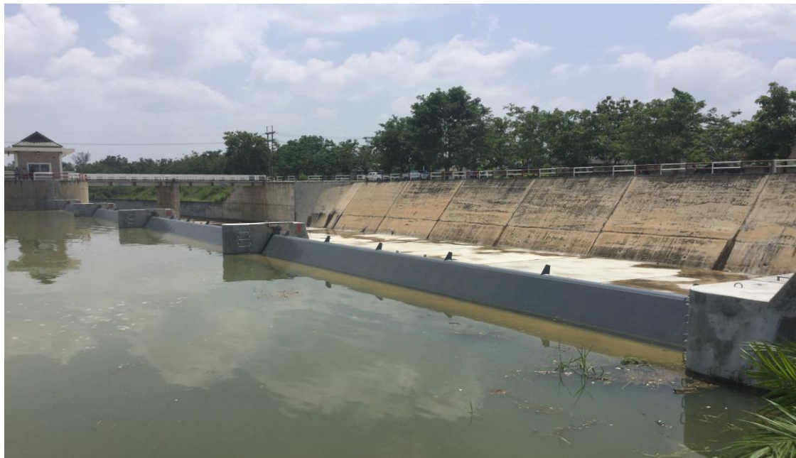
รูปที่ 11 อ่างเก็บน้ำเขื่อนประแสร์ ติดตั้งฝายพับได้ Type III-A เริ่มเก็บน้ำเพื่อช่วยป้องกันอุทกภัยทำอย่าง
