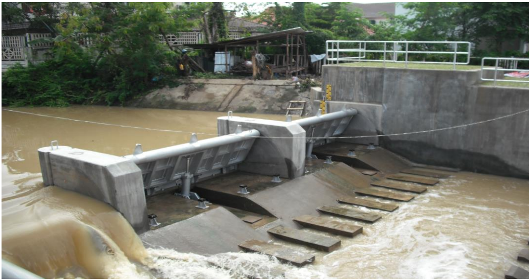
รูปที่ 2 ฝายพับได้ Type II-A บนสันฝายคอนกรีตของฝายบ้านต้นเปา อ.สันกำแพง จ.เชียงใหม่
