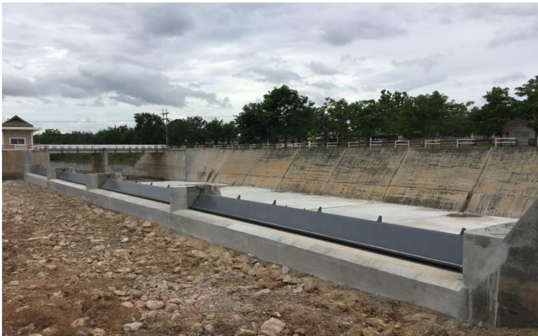
รูปที่ 9 ฝ่ายพันได้ Type III-A แบบอัตโนมัติ ที่ติดตั้งบนอ่างเก็บน้ำเขื่อนประแสร์ จ.ระยอง
