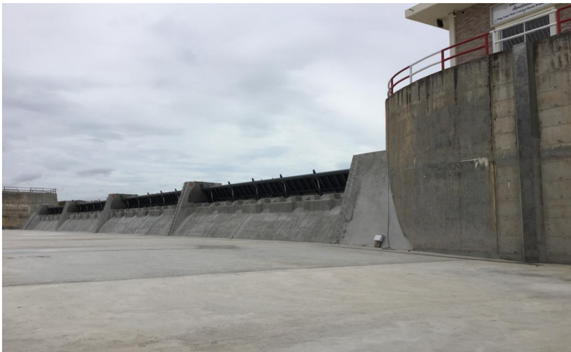
รูปที่ 6 ฝ่ายพับได้ Type III-A ติดตั้งที่ อ่างเก็บน้ำประแสร์ เพื่อเพิ่มความจุของอ่างเก็บน้ำ
