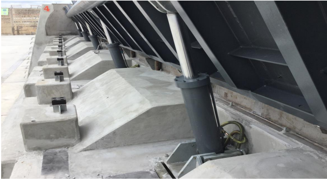
รูปที่ 10 ระบบไฮดรอลิก ของฝายพับได้ Type III-A แบบอัตโนมัติ ชนิดติดตั้งบนอ่างเก็บน้ำ เขื่อน ประแสร์ อ.วังจันทร์ จ.ระยอง
