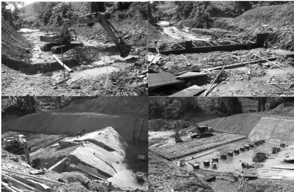
รูปที่ 8 การก่อสร้างฝายอนุรักษ์ต้นน้ำลำธารแบบถาวร (คอนกรีตเสริมเหล็กแบบสันกว้าง)
