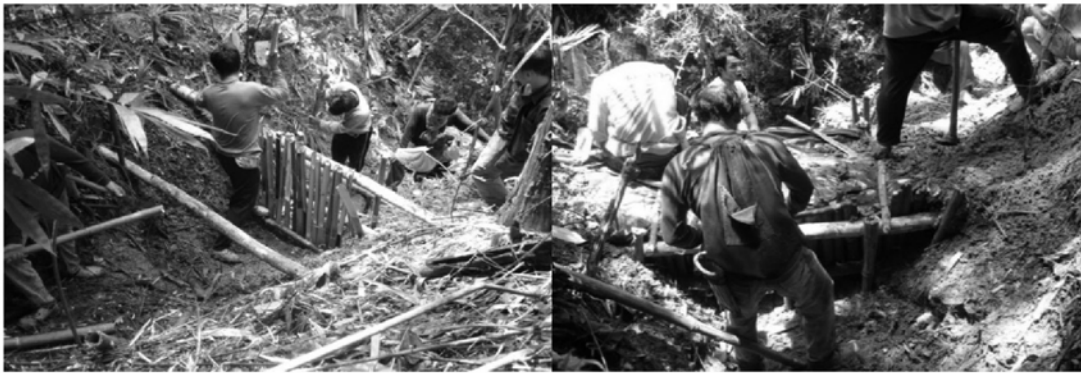
รูปที่ 7 การก่อสร้างฝายอนุรักษ์ต้นน้ำลำธารแบบท้องถื่นเบื้องต้น (ฝายคอกหมู)
