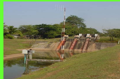
ระบบ SCADA โครงการส่งน้ำและบำรุงรักษาน้ำอน
