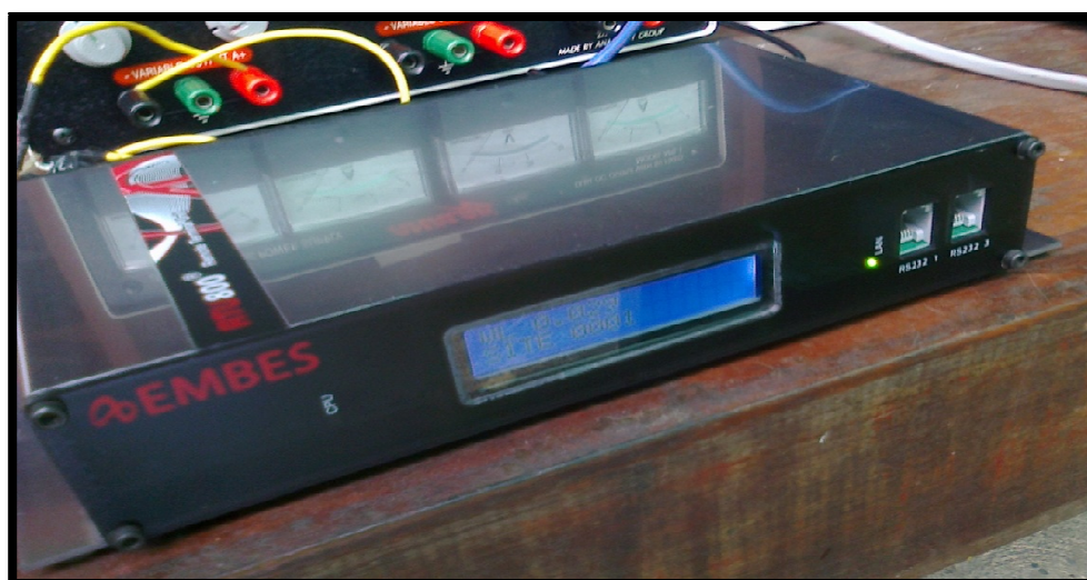
ภาพที่ 30 อ่านระดับน้ำที่วัดได้จากเครื่อง RTU800
