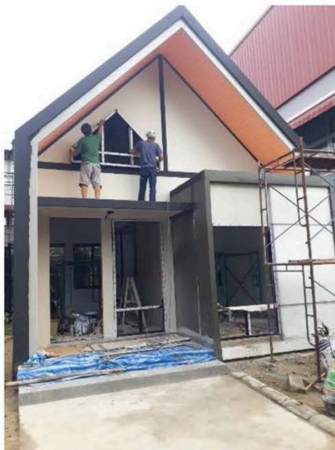
รูปที่ 10 การติดตั้งประตู-หน้าต่าง และเก็บรายละเอียด
