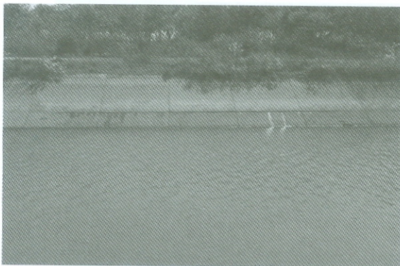
c) รอยแตกร้าวของแผ่นคอนกรีตทำให้มีน้ำได้ไหลซึมผ่านรอยแตก
