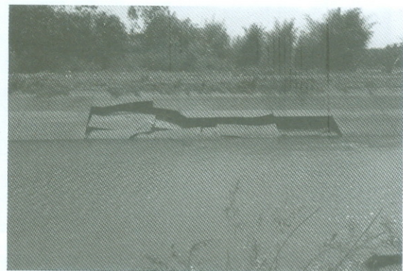
d) การพังทลายของลาดคลอง เนื่องจากแรงดันน้ำใต้แผ่นคอนกรีต
