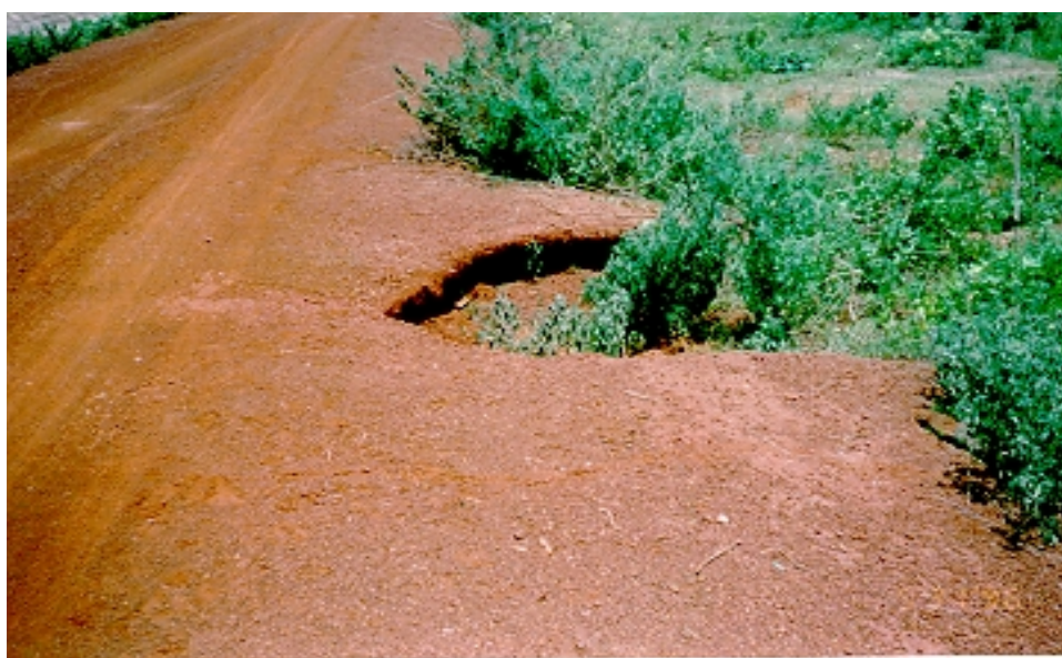
รูปที่ 7 ความเสียหายของคันดิน ประเภทที่ 2 การกัดเซาะเป็นรูปทรงบริเวณคันคลองด้านนอก
