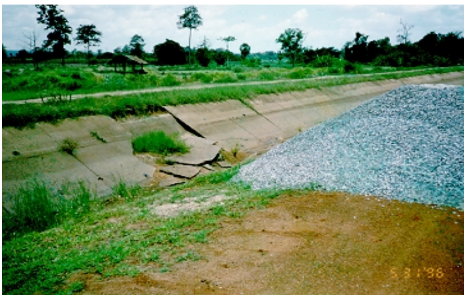
รูปที่ 15 ความเสียหายของคอนกรีตคาด ประเภทที่ 1 พังทะลาย
