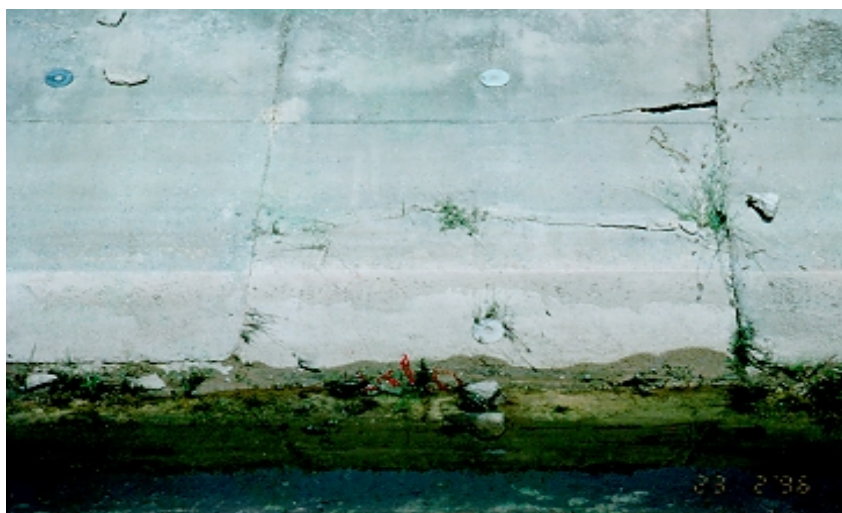
รูปที่ 17 ความเสียหายของคอนกรีตคาด ประเภทที่ 3 แตกร้าวต้องทุบซ่อม
