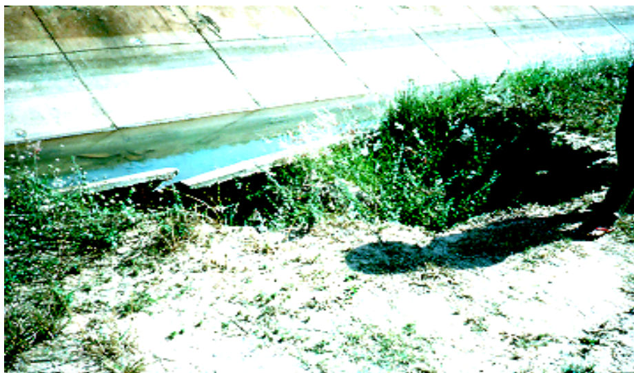
รูปที่ 6 ความเสียหายของคันดิน ประเภทที่ 1 เมื่อทิ้งไว้นาน ๆ ทำให้แผ่นคอนกรีตเสียหายไปด้วย
