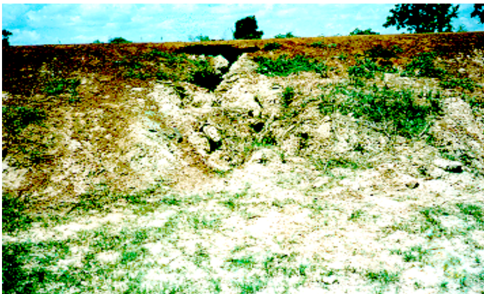
รูปที่ 8 ความเสียหายของคันดิน ประเภทที่ 2 การกัดเซาะเป็นรูปทรงบริเวณคันคลอง ด้านนอก
