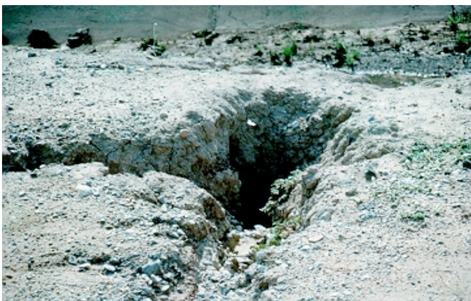
รูปที่ 5 ความเสียหายของคันดิน ประเภทที่ 1 ที่ไม่ได้รับการซ่อมแซมตั้งแต่แรกเริ่ม
