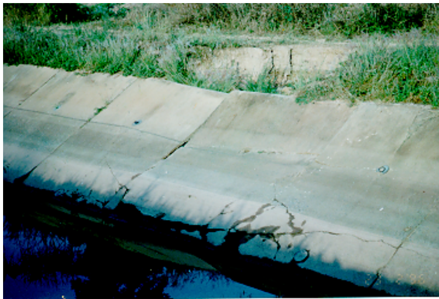
รูปที่ 18 ความเสียหายของคอนกรีตคาน ประเภทที่ 4 เคลื่อนตัว
