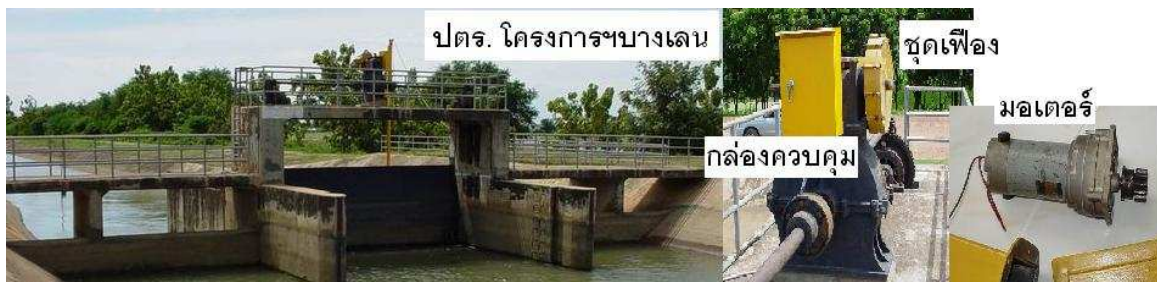
ปตร. โครงการบางเลนและระบบควบคุม
