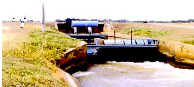
รูปที่ 3 ประตูน้ำอัตโนมัติแบบ Hydraulic ในโครงการส่งน้ำและบำรุงรักษาสองพี่น้อง
