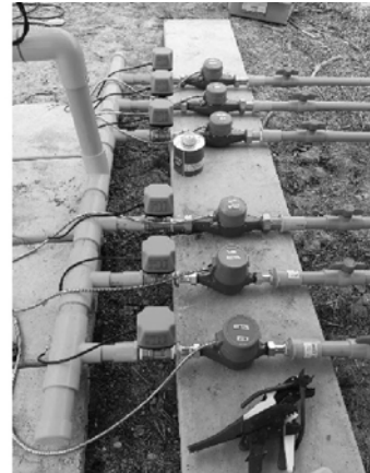
โซลินอยด์วาล์วและมิเตอร์วัดน้ำสำหรับ ท่อจ่ายน้ำให้ 6 แปลงทดลอง
