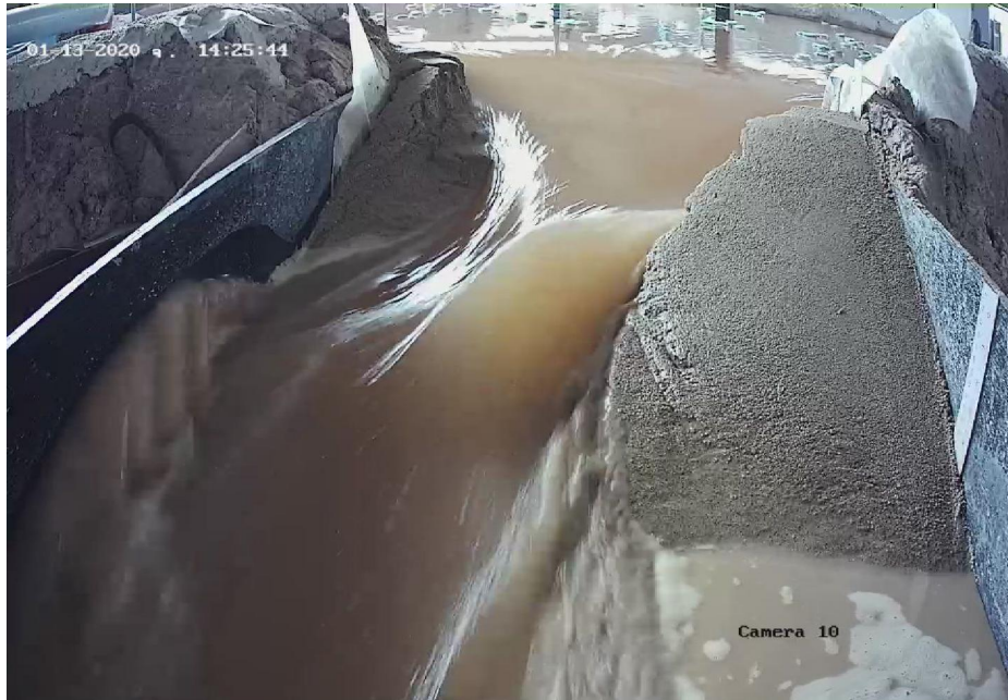
ภาพที่ ข1.5.แบบจำลองเขื่อนแก่งกระจานในขณะที่รอยแตกของเขื่อนกำลังขยายตัว
