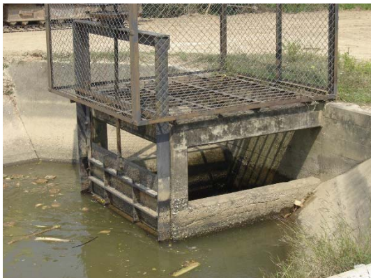
Mixed Regulator แบบความกว้างคลองจำกัดที่ Operate โมดของน้ำไหลตลอดได้บาน (โครงการส่งน้ำและบำรุงรักษาเพชรบุรี)
