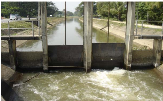
Mixed Regulator ที่ Operate โมดของน้ำไหลตลอดได้บาน (โครงการส่งน้ำและบำรุงรักษาเพชรบุรี)
