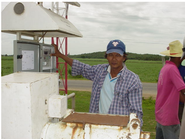
ฝึกให้เจ้าหน้าที่กวดปั๊มควบคุมการเปิด-ปิด ประตูระบายน้ำ ปตร.กลางคลอง 5L-2L กม.9+813
