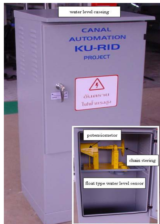
(2) ตู้เหล็กและ Sensor วัดระดับน้ำ
