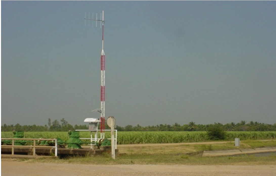
รูปที่ 4.31 ภาพสถานีลูกข่าย ที่ ปตร. กลางคลอง 5L-2L กม. 3+650 ก่อนติดตั้ง Gear Motor
