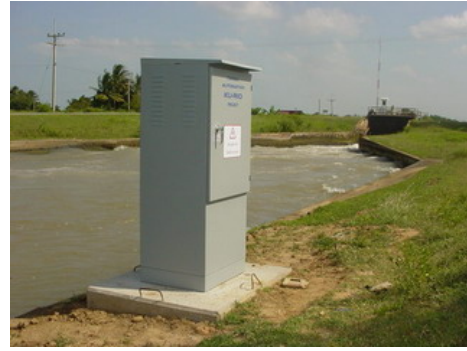
ตำแหน่งตู้ใส่อุปกรณ์วัดระดับน้ำ ซึ่งตั้งอยู่ด้านเหนือ น้ำของ ปตร. กลางคลอง
