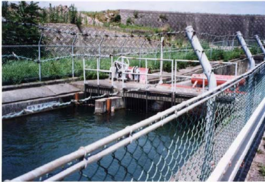
รูปที่ 49 ประตูน้ำอัตโนมัติ (ควบคุมระดับน้ำด้านเหนือน้ำ) ที่อยู่ร่วมกับประตูแบบธรรมดา
