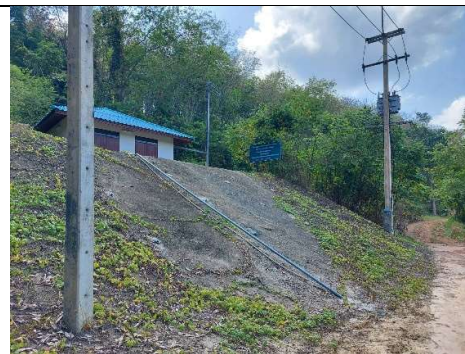
สถานีสูบน้ำด้วยไฟฟ้า อ.หลังสวน จ.ชุมพร 12 มี.ค. 65
