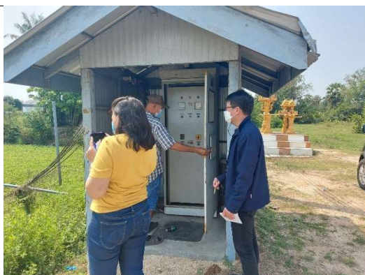
สถานีสูบน้ำด้วยไฟฟ้า อ.ชะอำ จ.เพชรบุรี 13 มี.ค. 65
