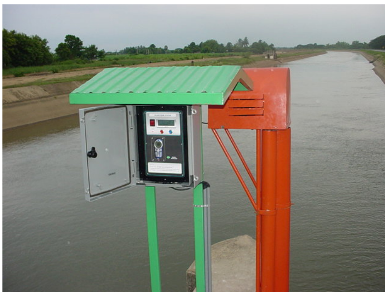
รูปที่ 29 Installation RTU and sensors หน้าประตูระบายน้ำ
