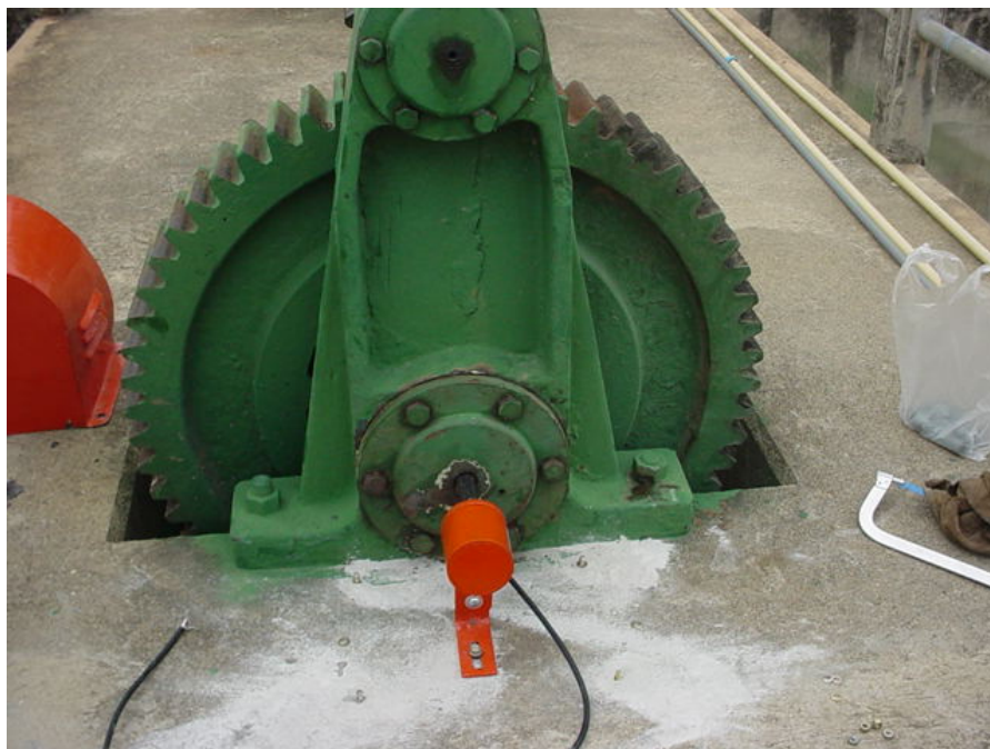
รูปที่ 25 การต่อแกน sensors วัดระยะเปิดประตูระบายน้ำ
