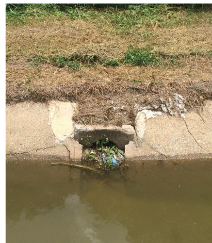
(ข) ความเสียหายของท่อส่งน้ำเข้าแปลง
