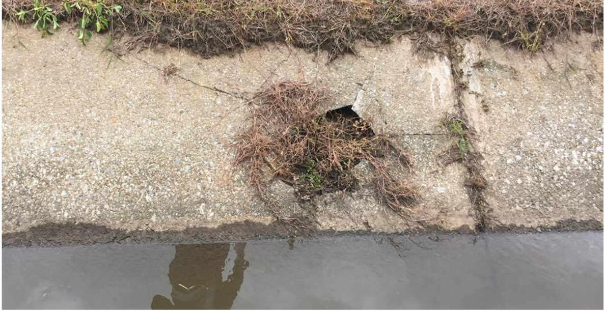
ภาพที่ 4-11 การพังทลายของแผ่นคอนกรีตของคลองส่งน้ำ 2L-1L-1
