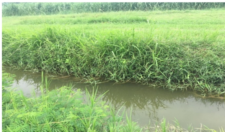
ภาพที่ 4-8 คลองมีหญ้าขึ้นปกคลุมไม่สามารถสำรวจได้ของคลองส่งน้ำ 1L-1
