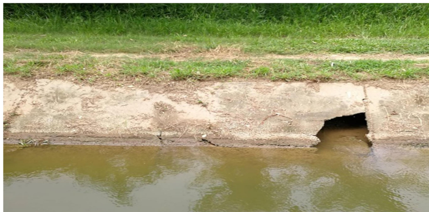
ภาพที่ 4-5 การพังทลายของแผ่นคอนกรีตของคลองส่งน้ำ 1L-1
