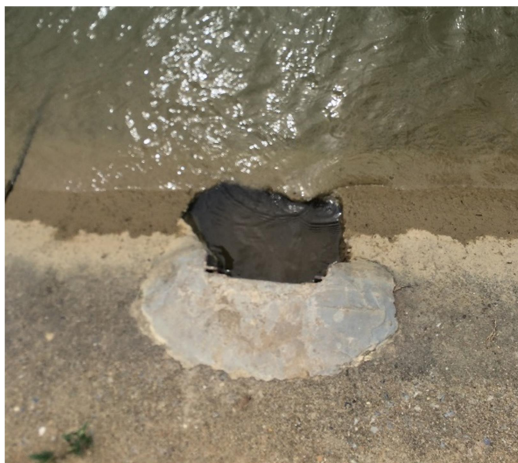
ภาพที่ 4-9 การเกิดความเสียหายอื่นๆ ของคลองส่งน้ำ 1L-1 (เกิดจากการยกเลิกใช้คูส่งน้ำและท่อส่งน้ำเข้านา)
